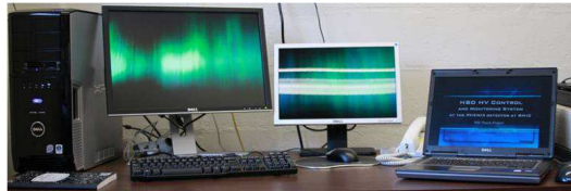
(d) HVC Client Control
