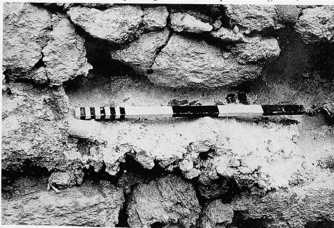
Fig. 27 Palais Nord. Empreintes de tasseaux transversaux à la base d'un chaînage longitudinal.
