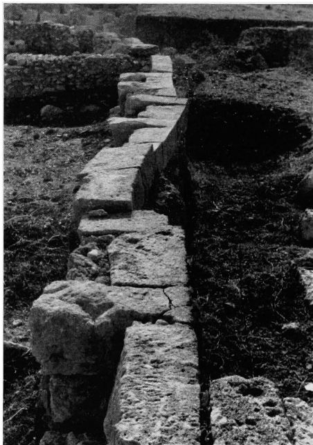
Fig. 29. — Assise inférieure de la façade d'un grand bâtiment au Sud du temple de Ba'al. La partie centrale de l'assise a glissé sur ses fondations à la suite d'un tremblement de terre (p. 33).
