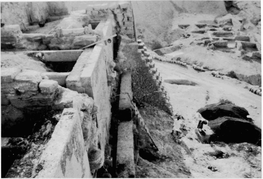
Fig. 5 - Palais du Stratège. Structure de la façade nord après les travaux de consolidation. À gauche, derrière la façade d'origine, les voiles de béton contenant les remblais antiques sont maintenus par des tirants qui vont s'ancrer à l'arrière. Au centre, la plateforme sur laquelle seront posés les nouveaux blocs qui remonteront la façade. À droite, tas de pouzzolane utilisée pour combler les vides existant entre les voiles de béton et les remblais antiques. Vue vers l'ouest.
