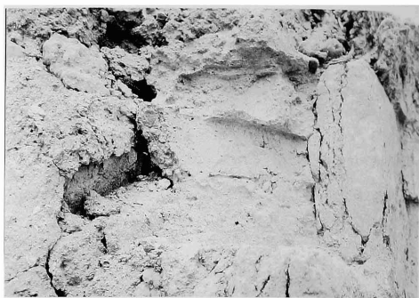
Fig. 19 - Marque \Delta sur le mur de pisé dans l'arrachement d'un chapiteau de section triangulaire.
